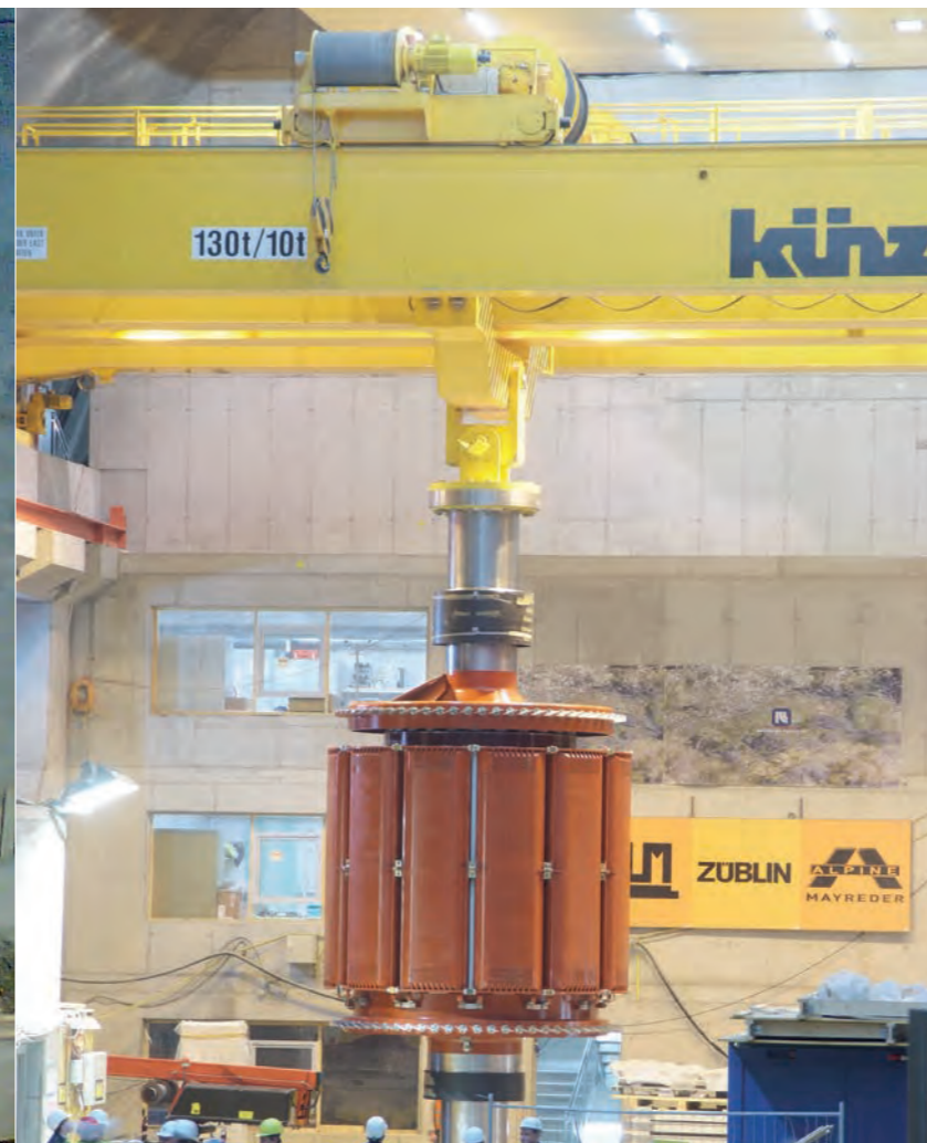
Maschinenhauskran (Foto: VIW)
