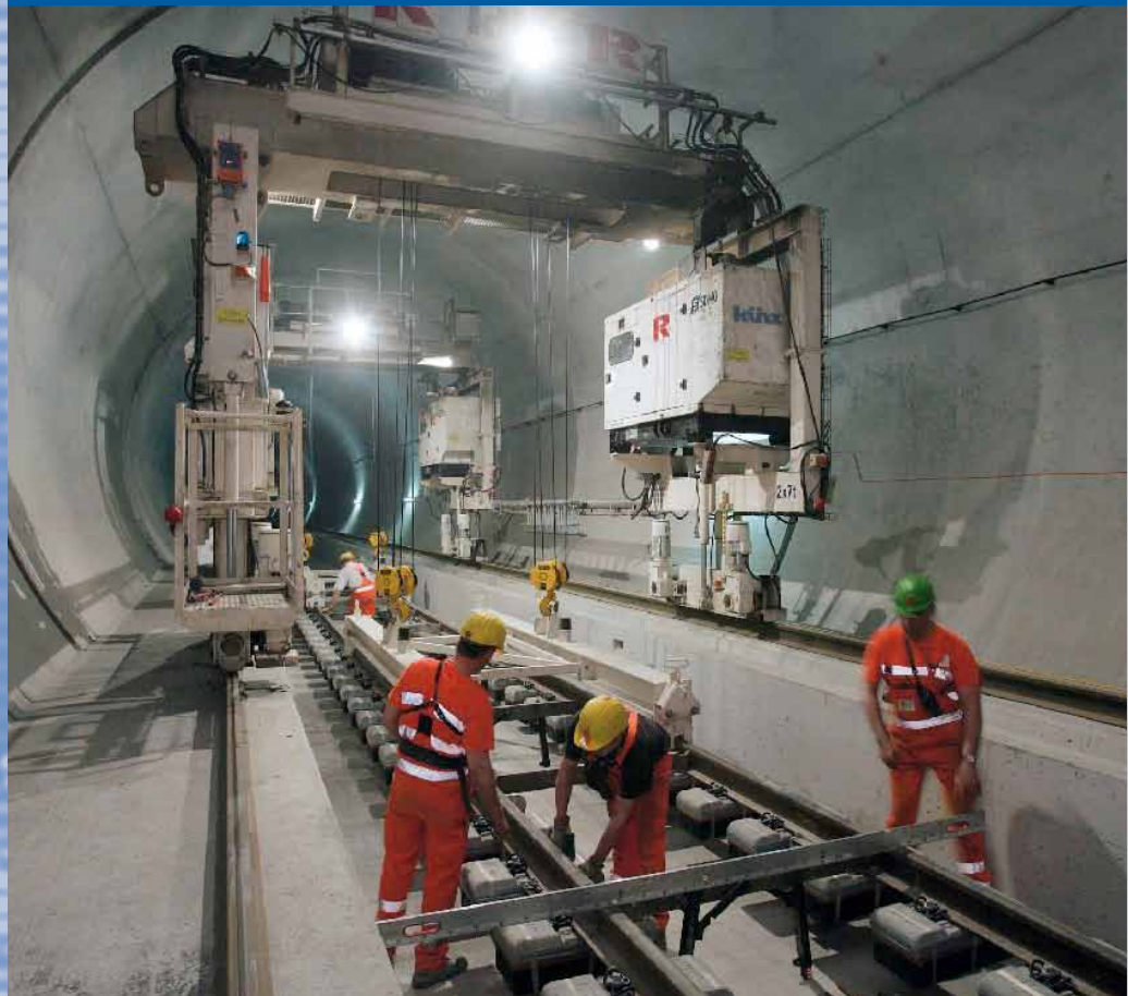
Der aus zwei Portalen bestehende selbstfahrende Sonderkran von Künz wird erfolgreich im Lötschbergtunnel eingesetzt.
